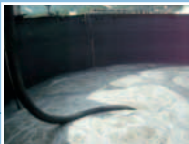
Aérateur type SCLK en fonction dans une cuve d'oxydation industrielle. Aereador sumergido modelo SCLK en función en tanque de oxidación.
